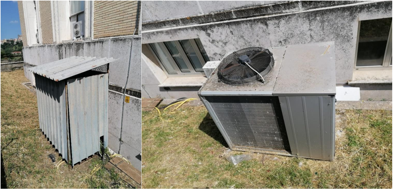
Figura 2-3 – Apparecchiature di refrigerazione di GHOSS fuori uso
