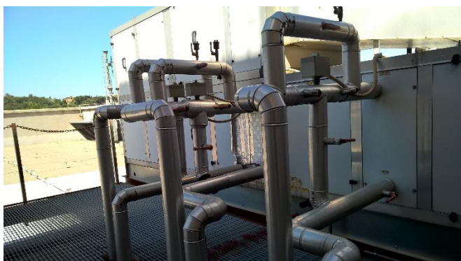
Figura 3 - UTA cupola principale a cui è collegato l'impianto termico
