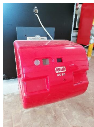
Figura 2 - Bruciatore RIELLO RS50 delle caldaie Edificio Principale
