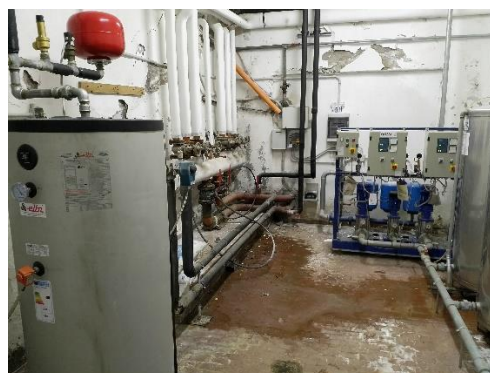
Figura 4 - Sottocentrale termica Edificio Principale.
