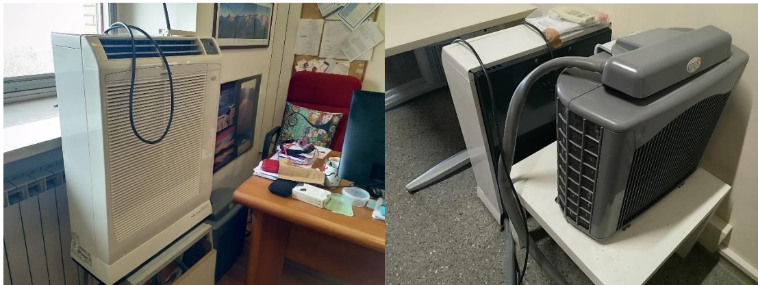
Figura 7 - Climatizzatori portatili da reinstallare nelle stanze 11, 23A e 23B
