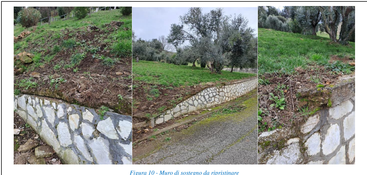
Figura 10 - Muro di sostegno da ripristinare
