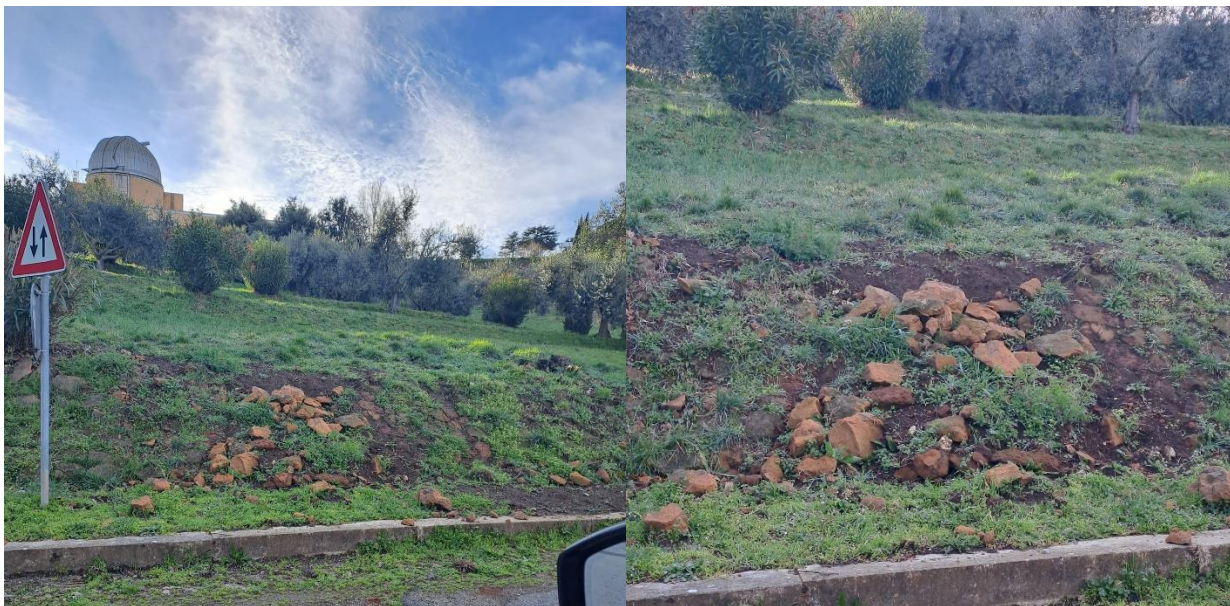
Figura 11 - Macera da ripristinare con allettamento in cls
