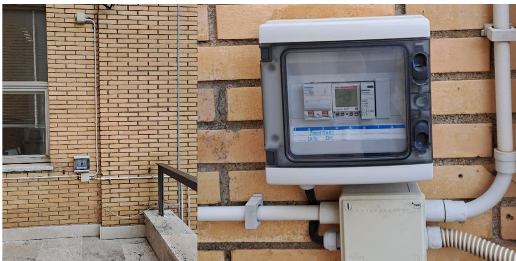
Figura 8 – Quadro elettrico a cui collegare la linea elettrica di alimentazione dell'impianto di illuminazione del marciapiede posteriore
