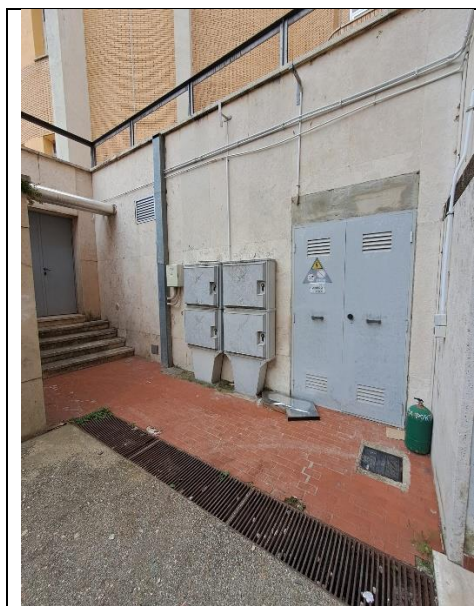
Figura 6 - Cabina elettrica ENEL (in fondo alla rampa posteriore lato sinistro dell'ed. principale)
