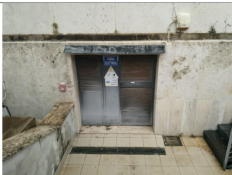
Figura 7 - Cabina elettrica di trasformazione dell'Osservatorio (posizionata sul lato destro dell'edificio principale)
