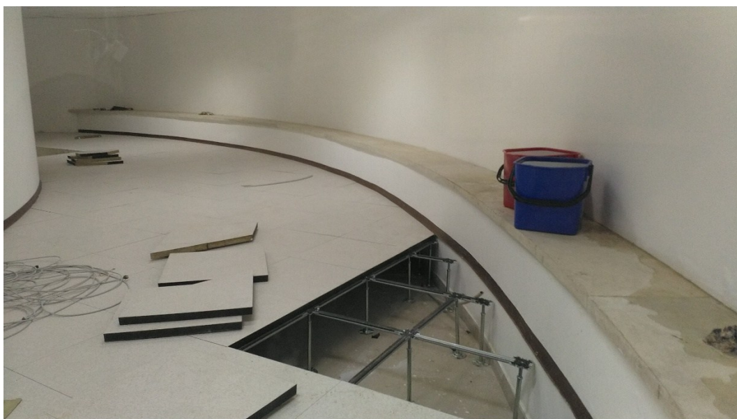
Figura 3 - Vista della sala CED
