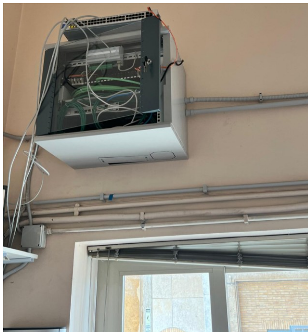
Figura 10 – RACK custodia con LMUP e UPS
