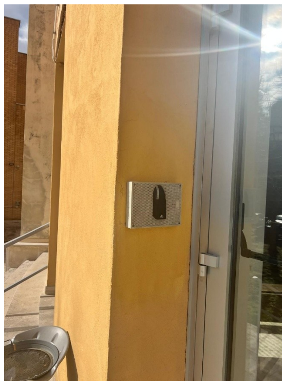
Figura 13 - Lettore apertura porta all'ingresso posteriore (j) (edificio principale)
