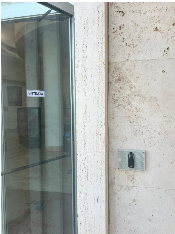
Figura 12 - Lettore apertura porta all'ingresso frontale (j) (edificio principale)
